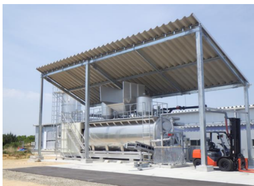
設備全体の様子
