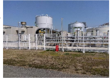
写真1 消化ガス発電施設 ガス発電機 25kw×(16+8)台
